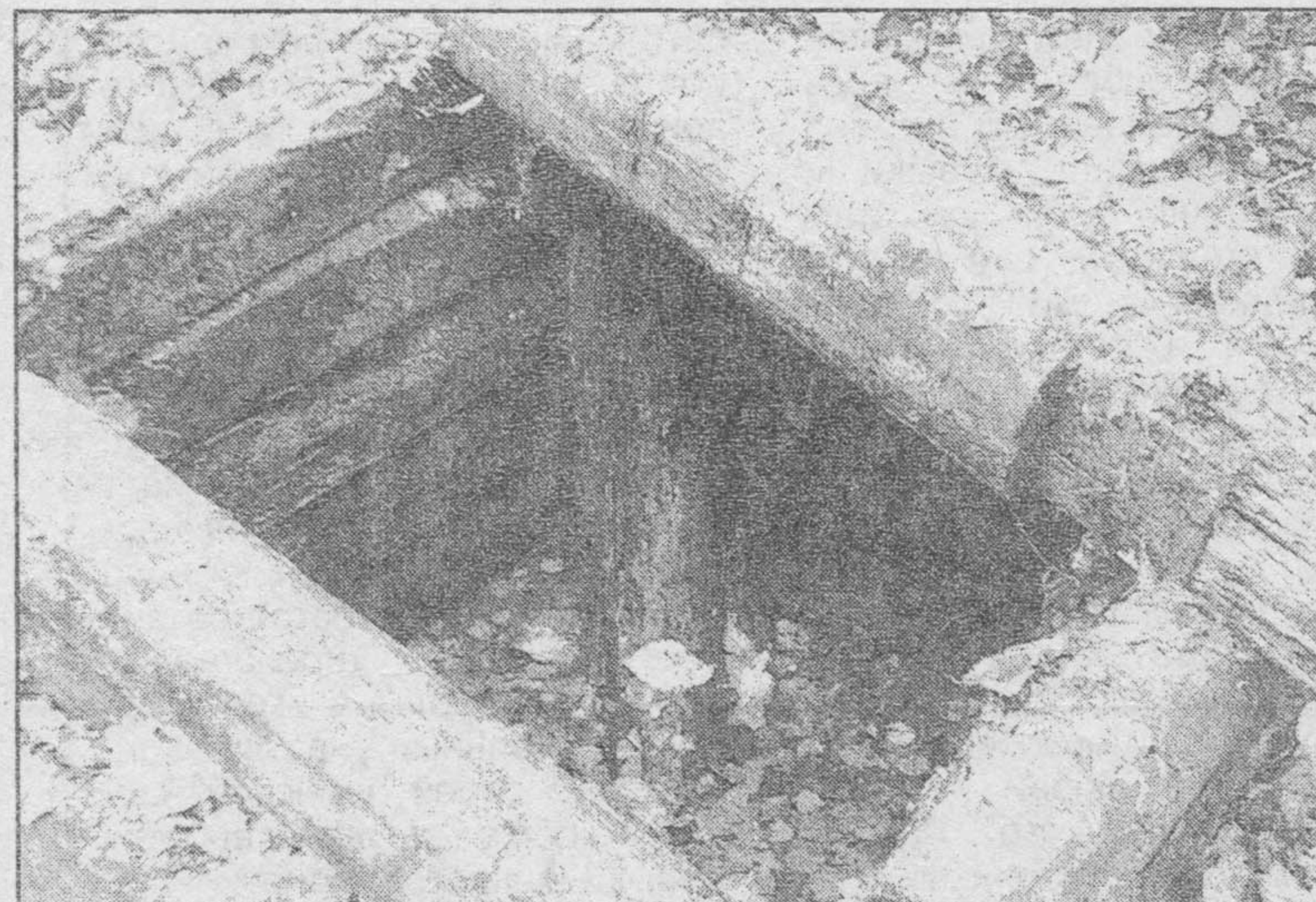
Разрушенный сруб источника.
